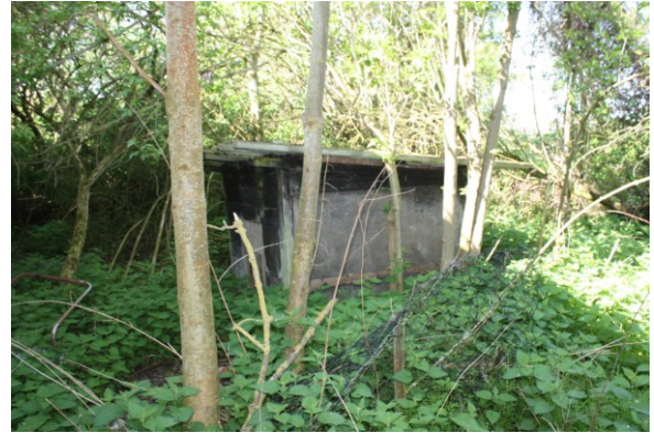
Schuppen mit Asbestdach hinter dem Wohngebäude
